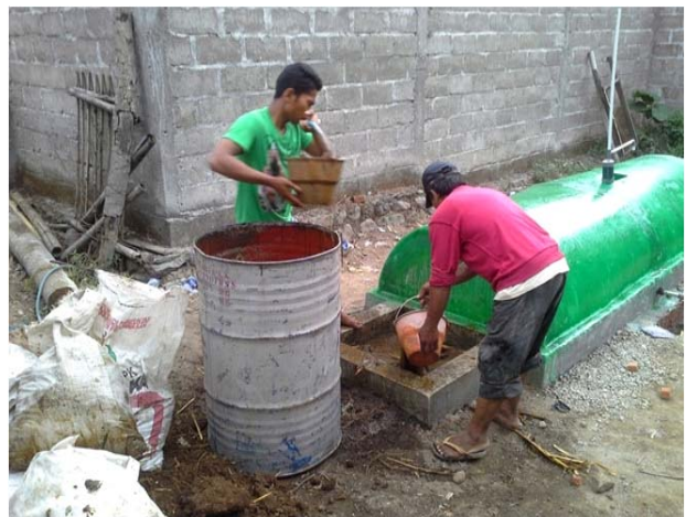
Gambar 5. Pemasukan Campuran Kotoran Sapi dan Air ke dalam Digester
